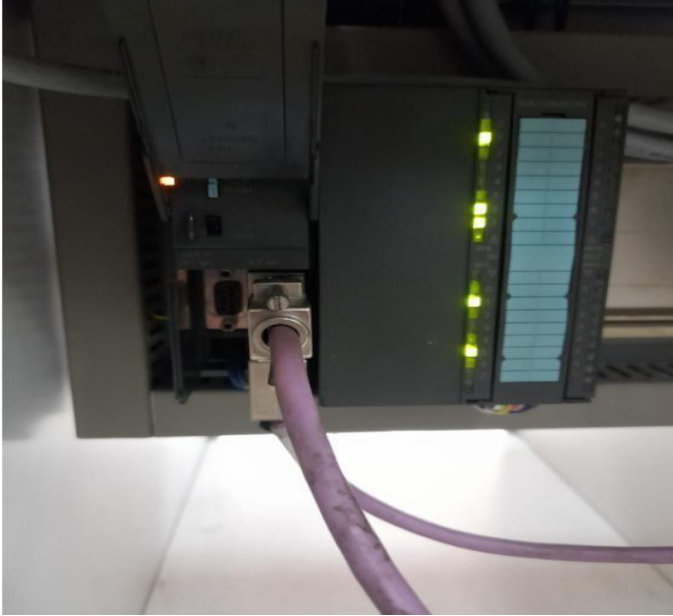
Figura 13: Verificación de conexión Profibus.
