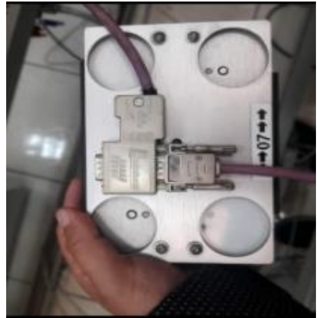
Figura 14: Verificación de conexión Profibus.
