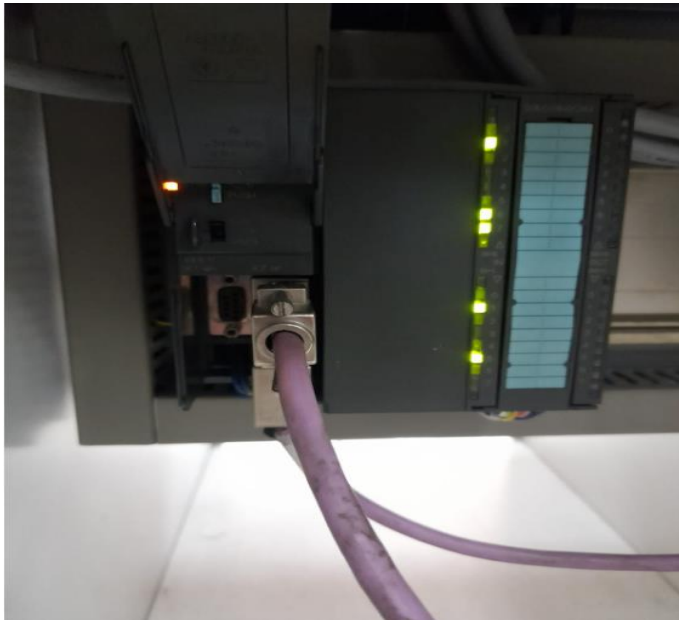
Figura 13: Verificación de conexión Profibus.
