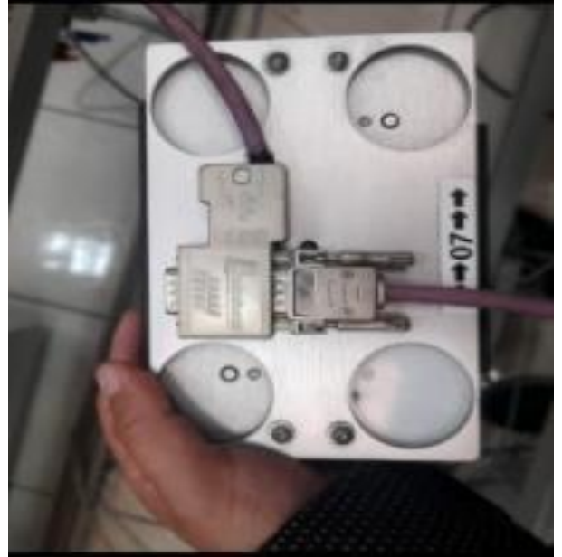
Figura 14: Verificación de conexión Profibus.
