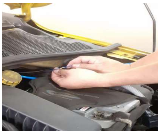
Figura 41.27: emparejamiento cable positivo del sistema de hidrógeno
