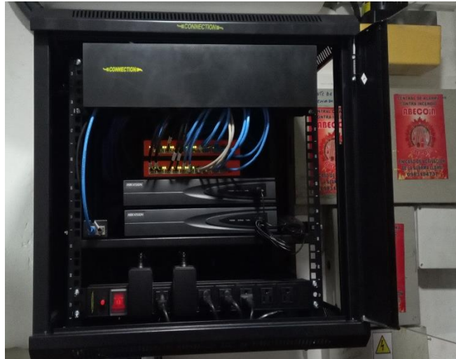
Figura 39. Rack de conexión dispositivos de red.
