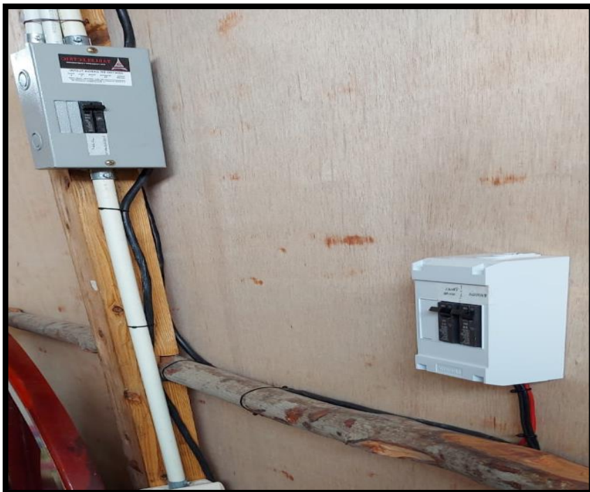
Figura 44: Montaje e instalación de los paneles de breakers (Instalación residencial y del control del PF), fuente: Los Autores.
