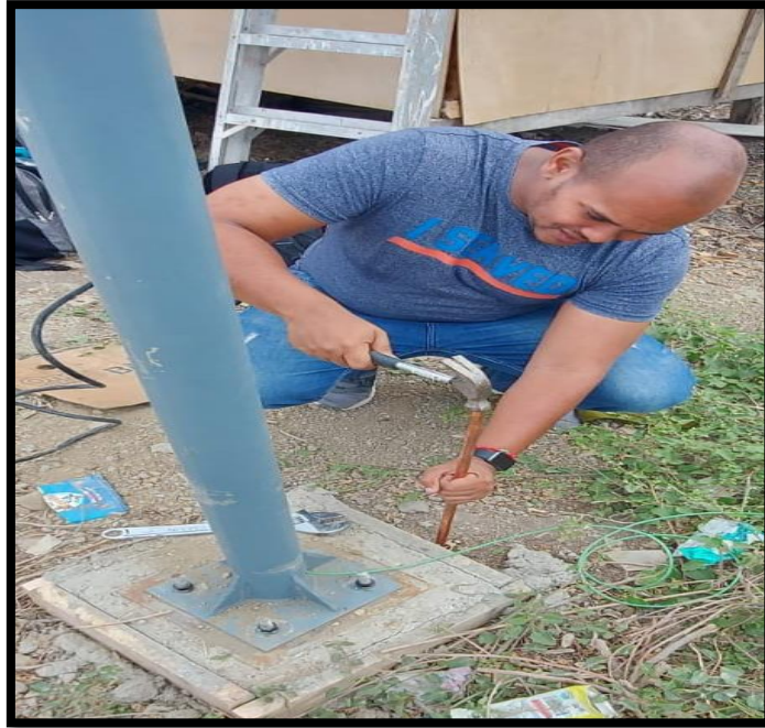
Figura 37: Colocación de su respectiva puesta a tierra para protección del equipo Fotovoltaico, fuente: Los Autores.
