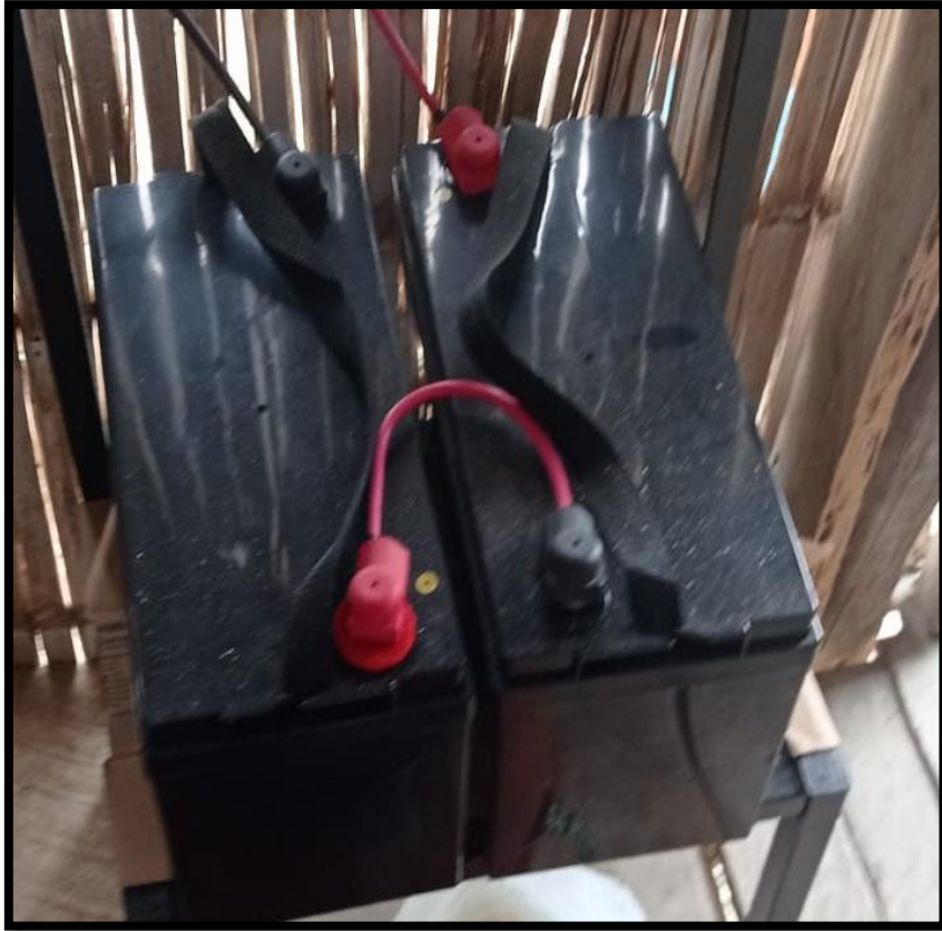
Figura 47: Montaje de baterías 12 VDC en soporte tipo banco, fuente: Los Autores.
