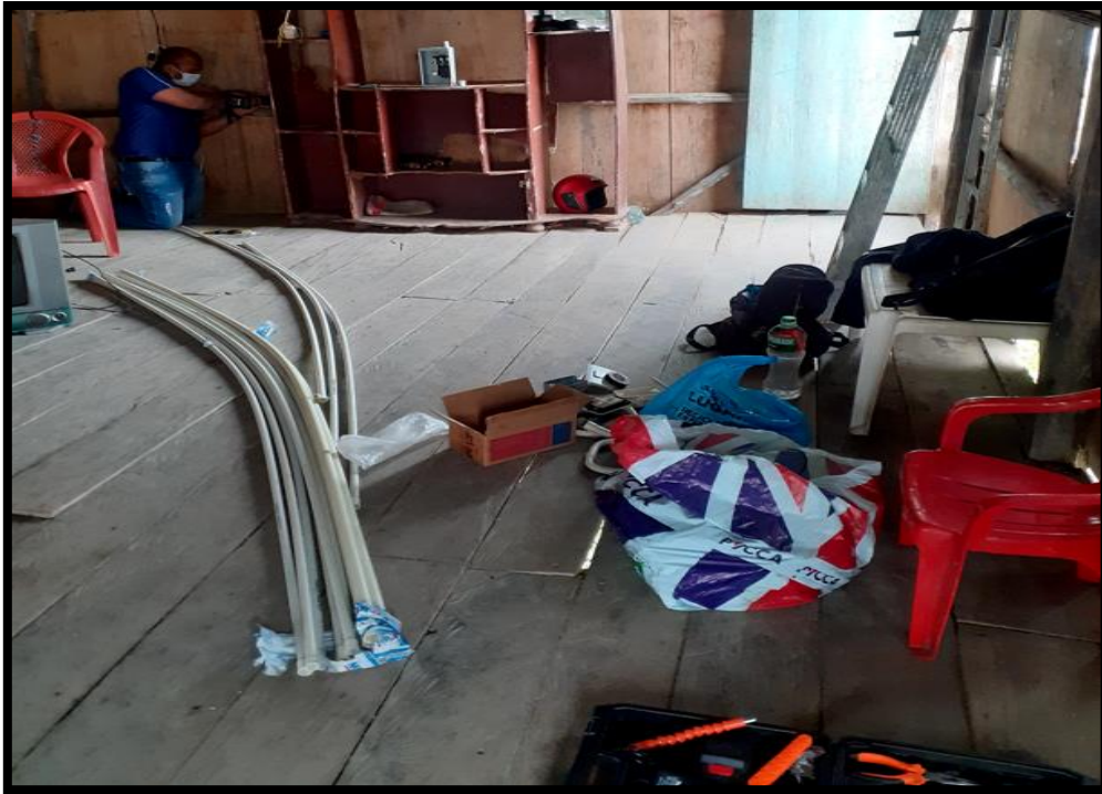
Figura 27: Materiales a utilizar en las instalaciones eléctricas de la residencia (tubería PVC, cajas de paso PVC, panel de breakers, piezas y acoples para montaje.), fuente: Los Autores.
