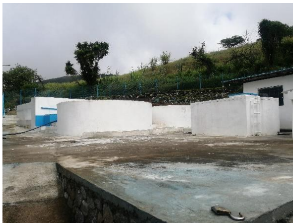
Figura 35 Planta de Tratamiento de Agua Potable que pertenece a la JAAP Lunduma.
