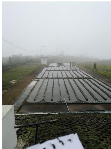
Figura 38 Planta Grande de Tratamiento de Agua Potable de Santa Isabel.
