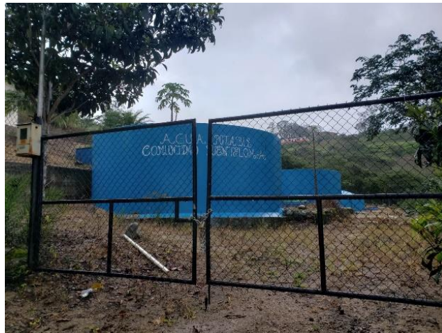
Figura 31 Planta de Tratamiento de Agua Potable de la JAAP Puenteloma.
