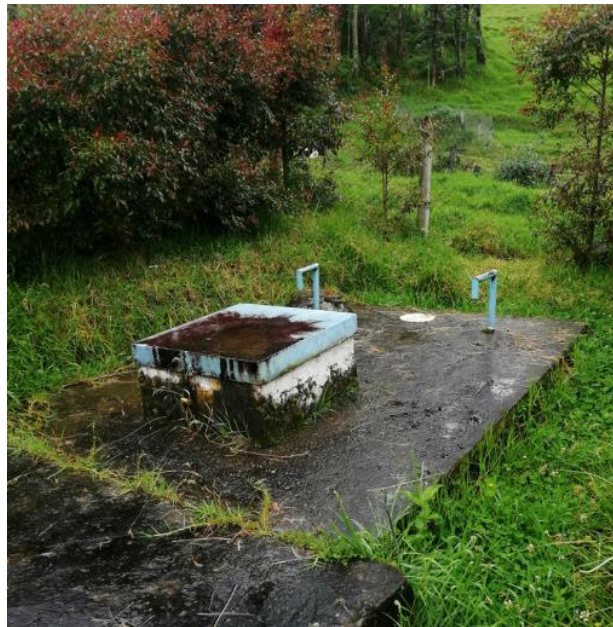
Figura 29 Pequeña Planta de Tratamiento de Agua Potable San Vicente.
