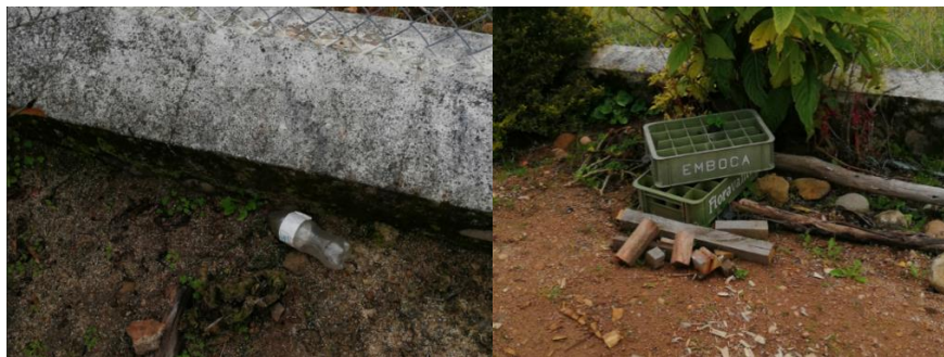
Figura 10 Caja y botella de plástico que se encuentra dentro de la planta de tratamiento de agua potable Pichil.
