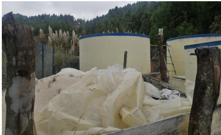
Figura 12 Planta de tratamiento de agua potable de Cochaseca.
