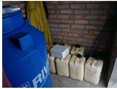
Figura 5 Cisterna de cloro y galones plásticos en la caseta de cloración.
