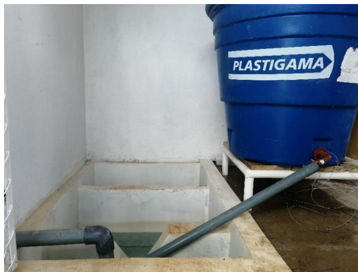
Figura 37 Tanque de Cloración en la Planta de Tratamiento de Agua Potable de la JAAP Dandan.
