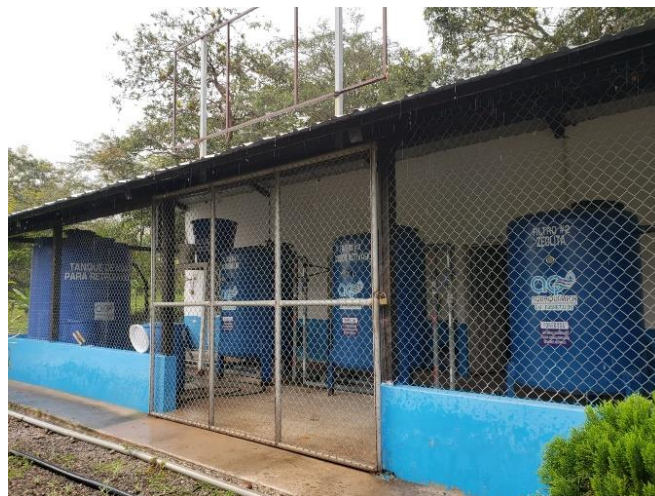
Figura 32 Planta de Tratamiento de Agua Potable de la JAAP Abdón Calderón.
