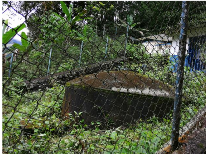
Figura 42 Planta de Tratamiento de Agua Potable que pertenece a la JAAP Pindo.
