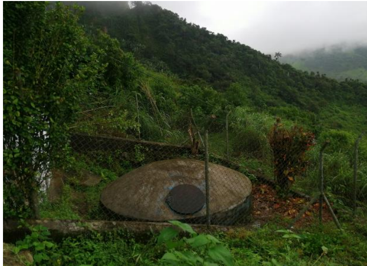
Figura 41 Planta de Tratamiento de Agua Potable que pertenece a la JAAP San Sebastián
