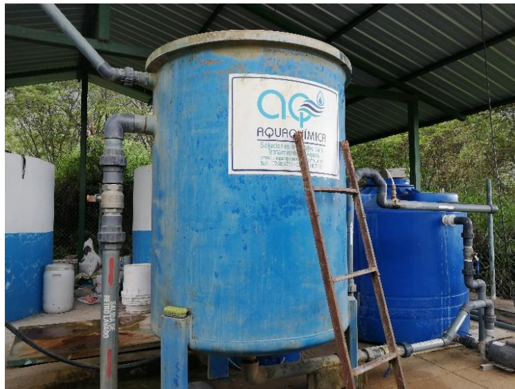
Figura 34 Unidades que conforman la planta de tratamiento de Agua Potable de la JAAP Sulupali Chico.
