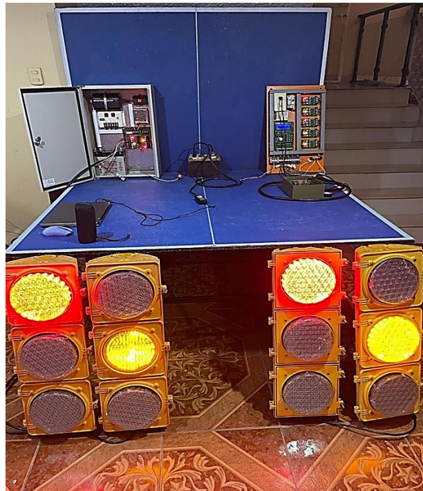
Fig. 35.- Prueba de Funcionamiento 2 Fuente: Autor
