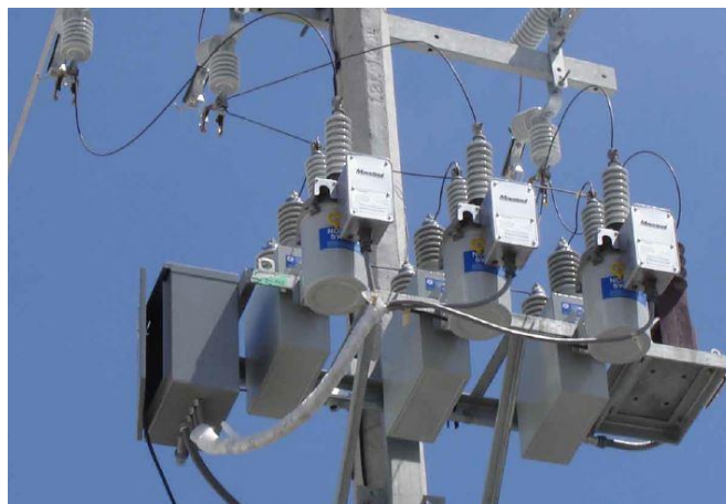
Figura 13: Banco de capacitores fijos [18]
