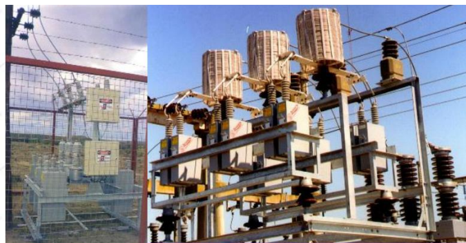
Figura 14: Banco de capacitores automáticos [16]
