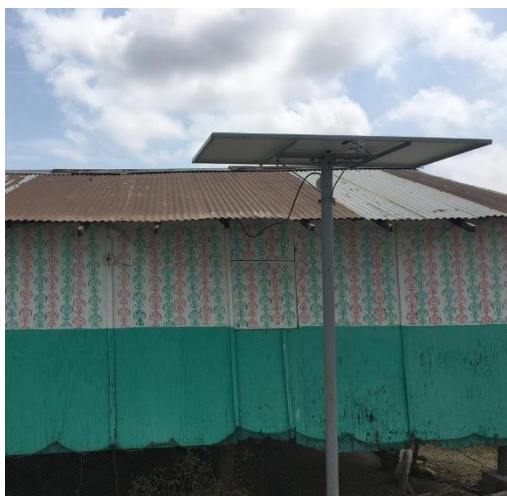
Figura 40 Panel solar en su ubicación
