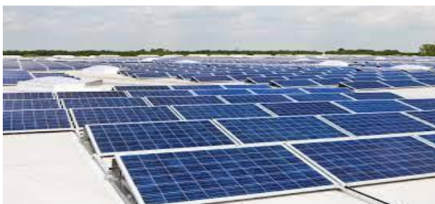
Figura 5. Energía solar térmica.
