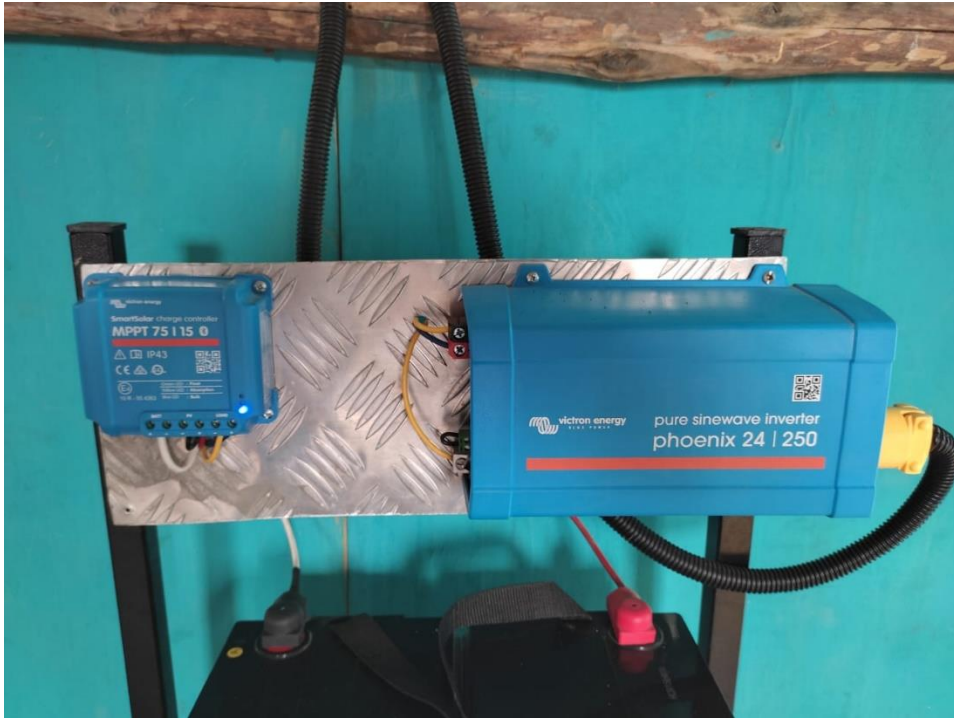
Figura 21. Sistema fotovoltaico instalado dentro de la vivienda beneficiada
