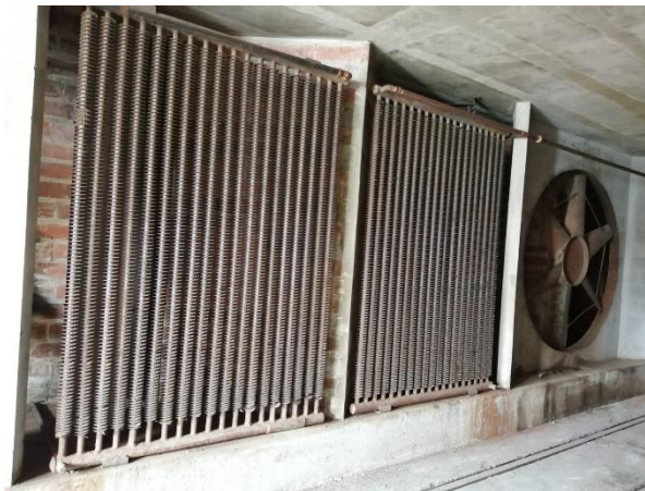
Ilustración 25. Radiadores y Ventiladores de las cámaras de secado
