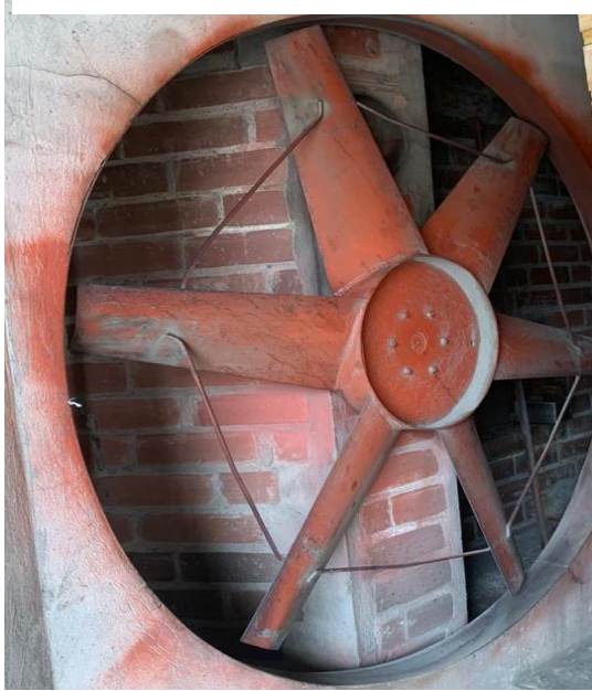
Ilustración 24. Mantenimiento de ventiladores
