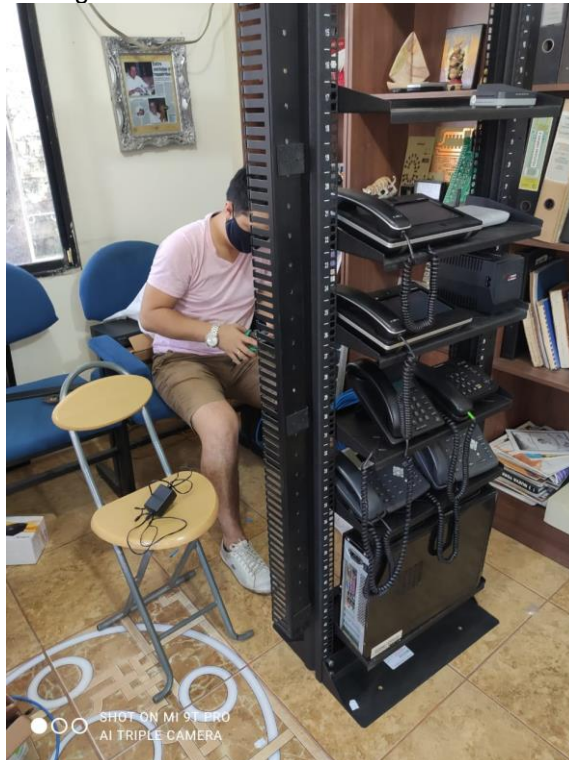
Figura 4.10 Cableado de hardware VOIP
