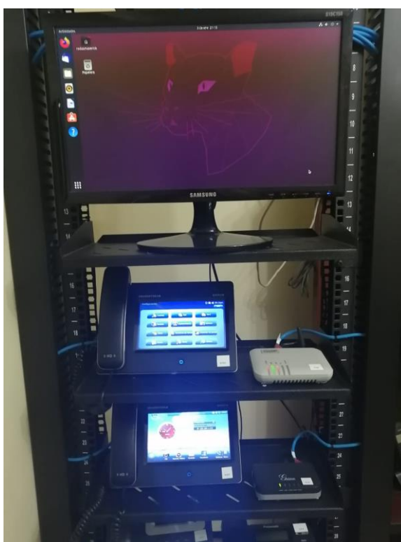
Figura 4.22 Instalación final de hardware VOIP
