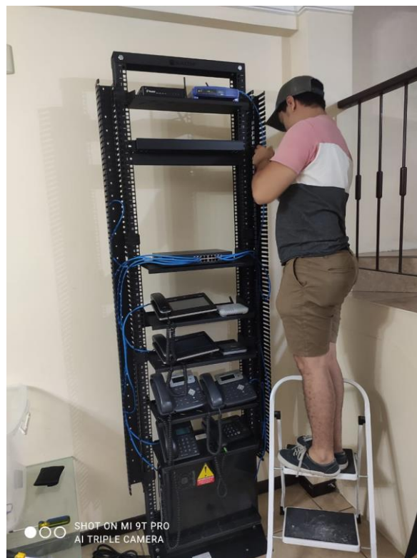
Figura 4.12 Conexión de hardware VOIP
