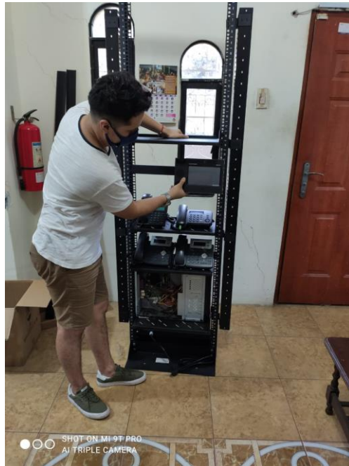
Figura 4.9 Instalación de hardware VOIP
