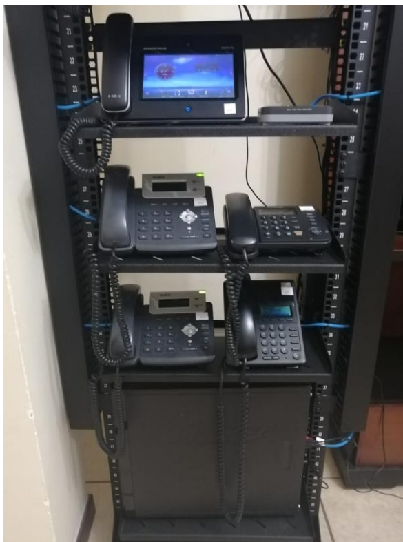
Figura 4.21 Instalación final de laboratorio de comunicaciones unificadas
