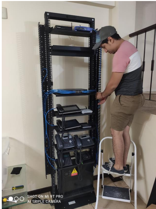
Figura 4.13 Conexión de hardware VOIP
