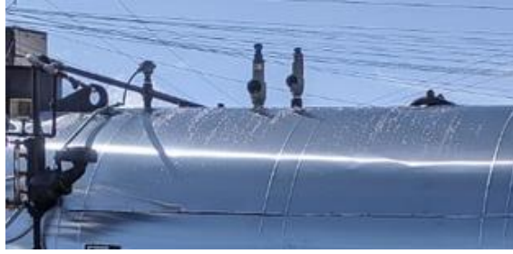
Figura 10. Válvulas de seguridad de caldera pirotubular.
