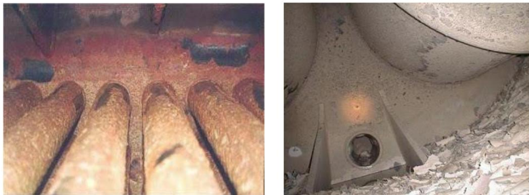
Figura 25. Incrustaciones en los tubos de humo y en el cuerpo de la caldera.
