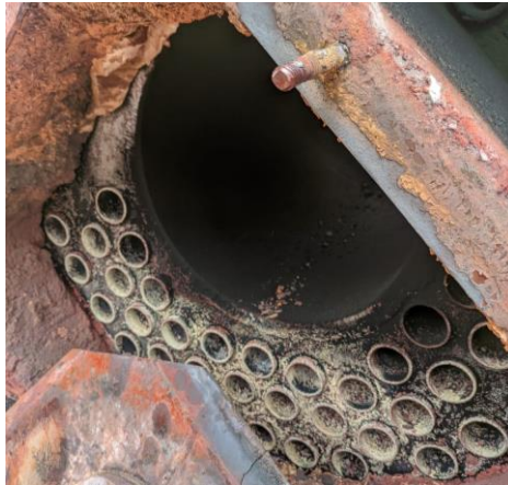
Figura 28. Tubos de fuego con presencia de hollín en su interior.
