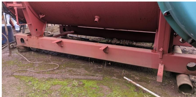
Figura 6. Base de soporte de una caldera de 250 BHP.
