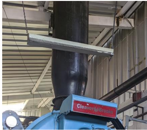
Figura 9. Chimenea de caldera.
