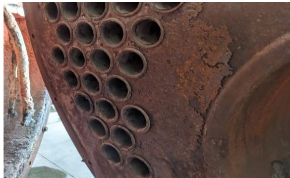
Figura 21. Disminución de espesor por presencia de corrosión en los espejos de la caldera.
