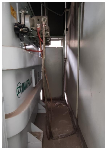
Figura 33. Conexión del neutro a tierra del Transformador de 1.5 MVA sección Polyalgon
