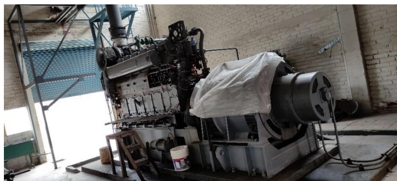
Figura 16. Generador eléctrico de 750 kVA
