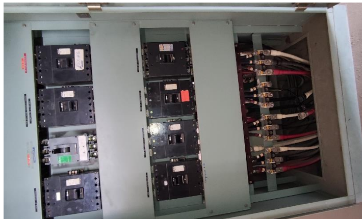
Figura 28. Interruptores tablero principal sección Poy
