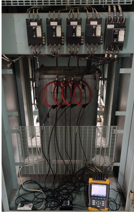
Anexo 12. Analizador de red conectado al secundario transformador 50 kVA
