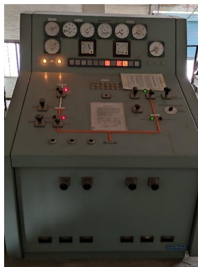
Figura 18. Tablero de transferencia de potencia manual
