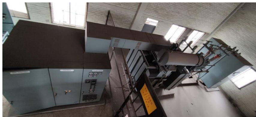
Figura 14. Transformador 2 MVA S/E Principal
