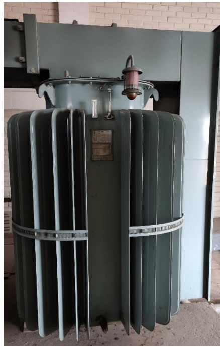
Figura 25. Transformador 1 MVA sección Poy
