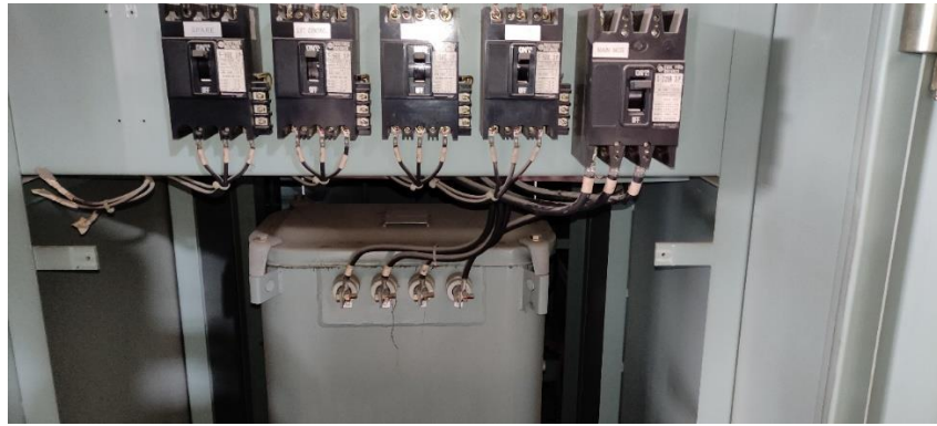
Figura 30. Transformador 50 kVA e interruptores de sobre corriente
