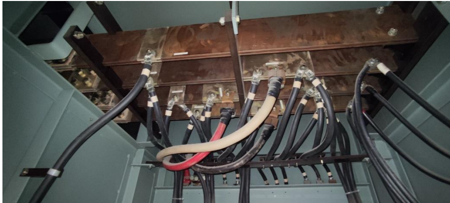
Figura 27. Barras del tablero principal de la sección de Poy
