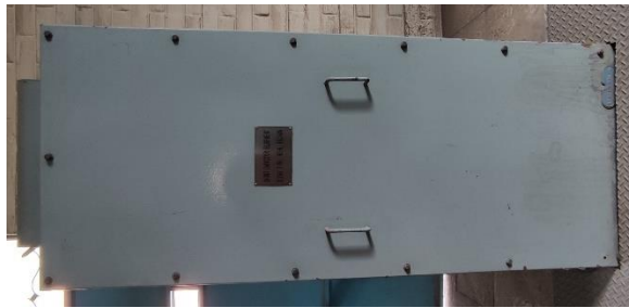
Figura 19. Banco de condensadores 150 kVAr - 3.3 Kv
