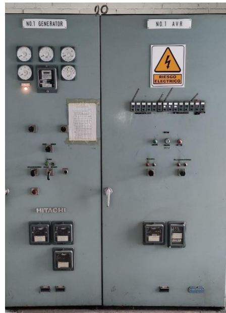
Figura 17. AVR y Protecciones del Generador
