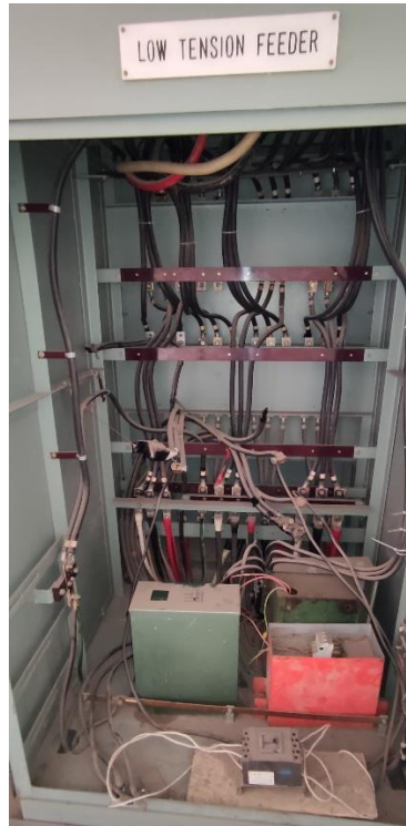
Figura 29. Vista posterior del tablero principal sección Poy
