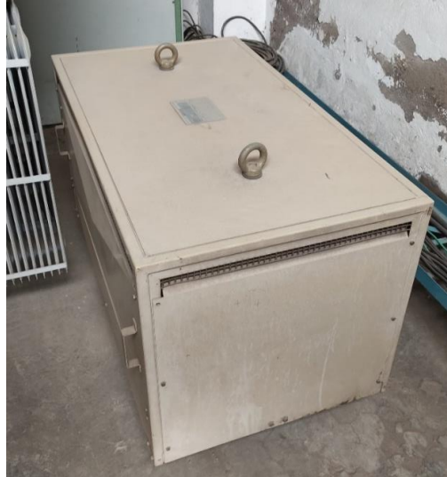
Figura 36. Autotransformador 100 kVA sección Polyalgodon
