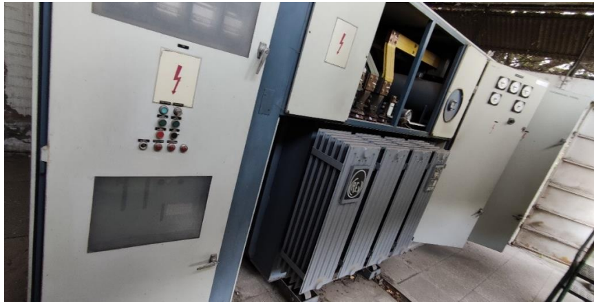
Figura 21. Transformador 1 MVA y barras del secundario
