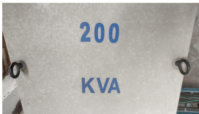
Figura 35. Autotransformador Tipo Seco 200 kVA sección Polyalgodon
