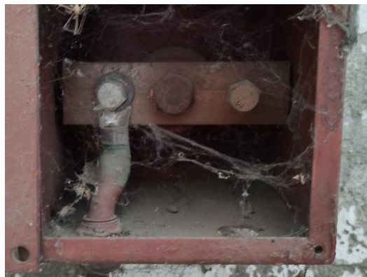
Figura 24. Borne de puesta a tierra sección Texturizado
