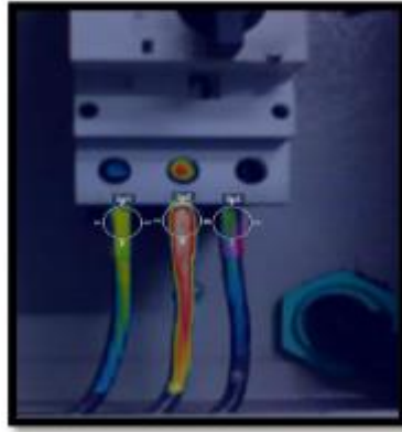
Figura 9. Imagen termográfica en cableado de sistema desbalanceado [33]
