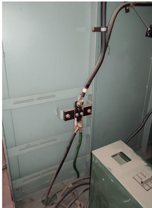
Figura 26. Conductor del neutro del transformador aterrizado
