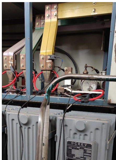
Figura 22. Conexión de barras a transformador de Texturizado
