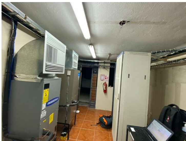
Figura 2. Nodo Chiriboga de la empresa Telconet S.A.
