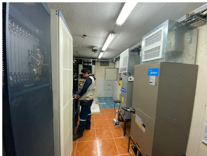
Figura 1. Nodo Chiriboga de la empresa Telconet S.A.
