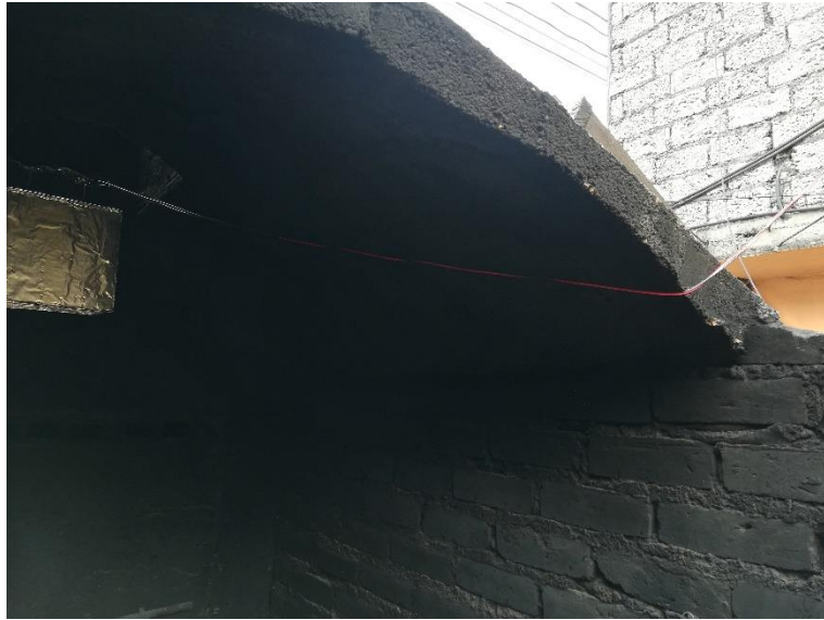
Anexo 8: Fuente de calor.
