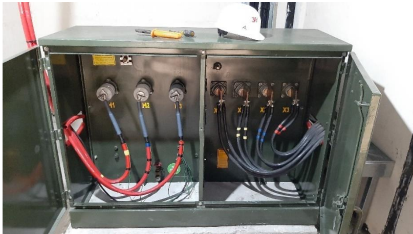
Figura 16. Transformador tipo Pad Mounted. Fuente: Los Autores.
