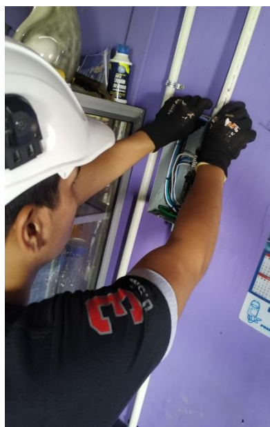
d) Caja de breakers
