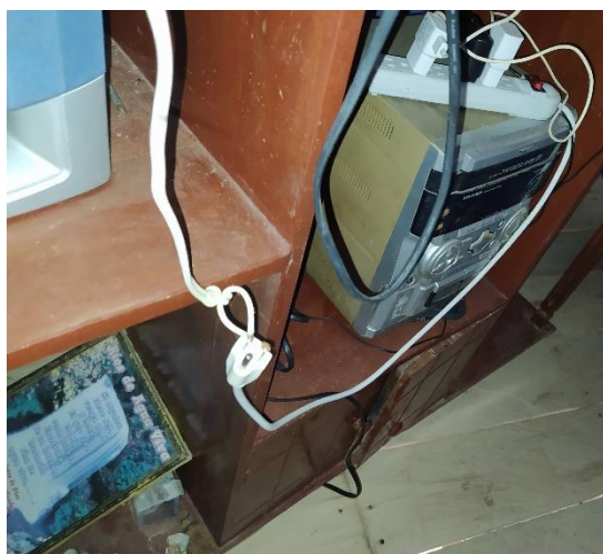
c) Cables expuestos
