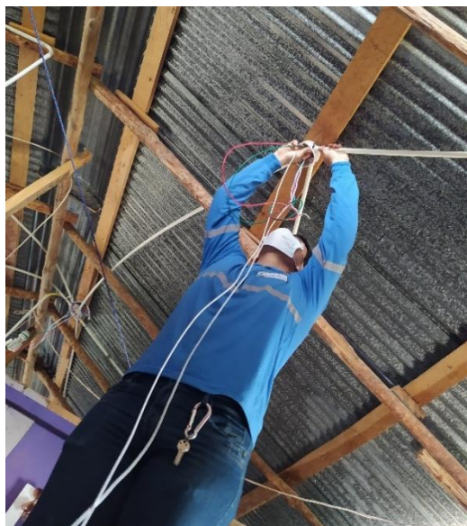
b) Cableado del circuito de iluminación
