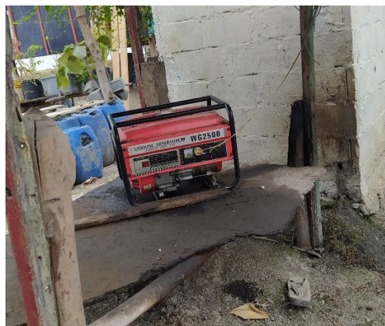
Ilustración 10. Generador utilizado por la vivienda. Fuente: Autor
