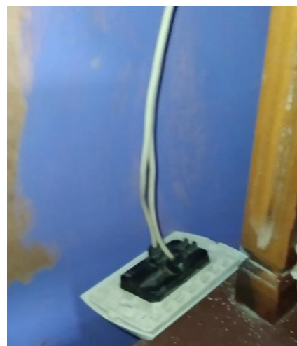
d) Tomacorrientes sin fijación ni aislamiento
