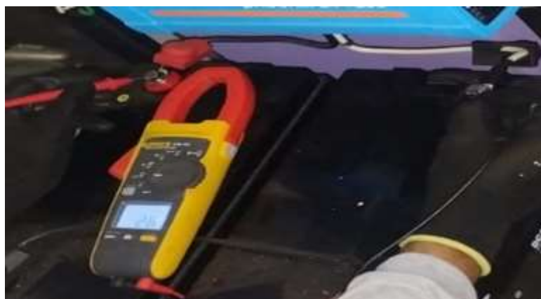
FIG. 54. MEDICIÓN DE VOLTAJE A VACÍO EN LAS BATERÍAS (AUTOR)
