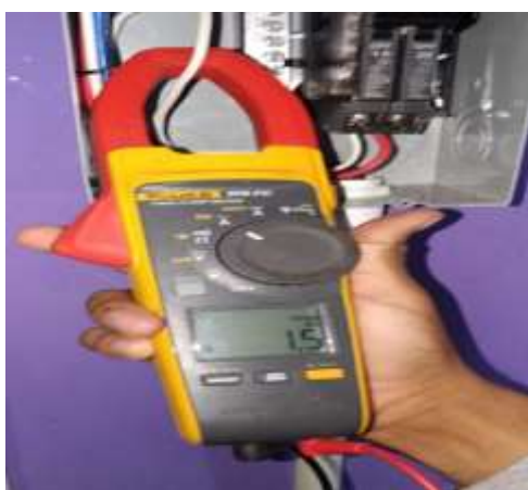
FIG. 55. LECTURA DE CORRIENTE A PLENA CARGA (AUTOR)
