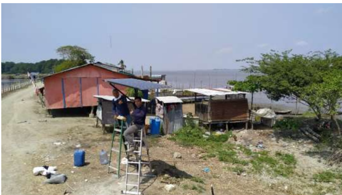
FIG. 71.1. MONTAJE Y AJUSTE DE TODOS LOS PERNOS DEL PANEL SOLAR, AL SOPORTE EXTERIOR (AUTOR)
