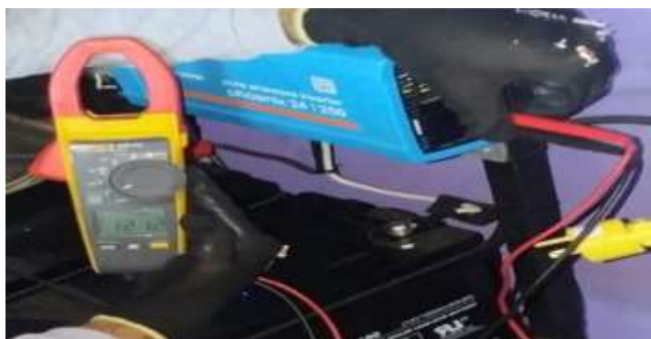
FIG. 54.2. SALIDA DE VOLTAJE AC DEL INVERSOR, SE VISUALIZA UN VOLTAJE AC DE 121,2V. (AUTOR)
