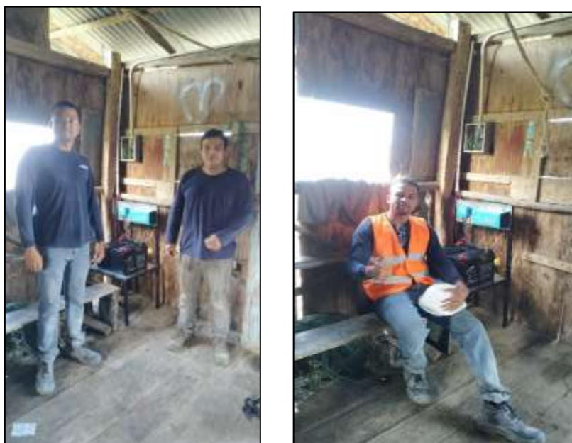
FIG. 74. INSTALACIÓN INTERIOR DEL KIT FOTOVOLTAICO INSTALADA (AUTOR)
