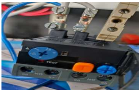
FIG. 57. RELÉ TÉRMICO CONECTADO A NUESTRO SISTEMA (AUTOR)
