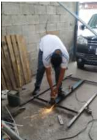
FIG. 66. PILUDO DE LOS SOPORTE EXTERNO DEL SISTEMA FOTOVOLTAICO (AUTOR)
