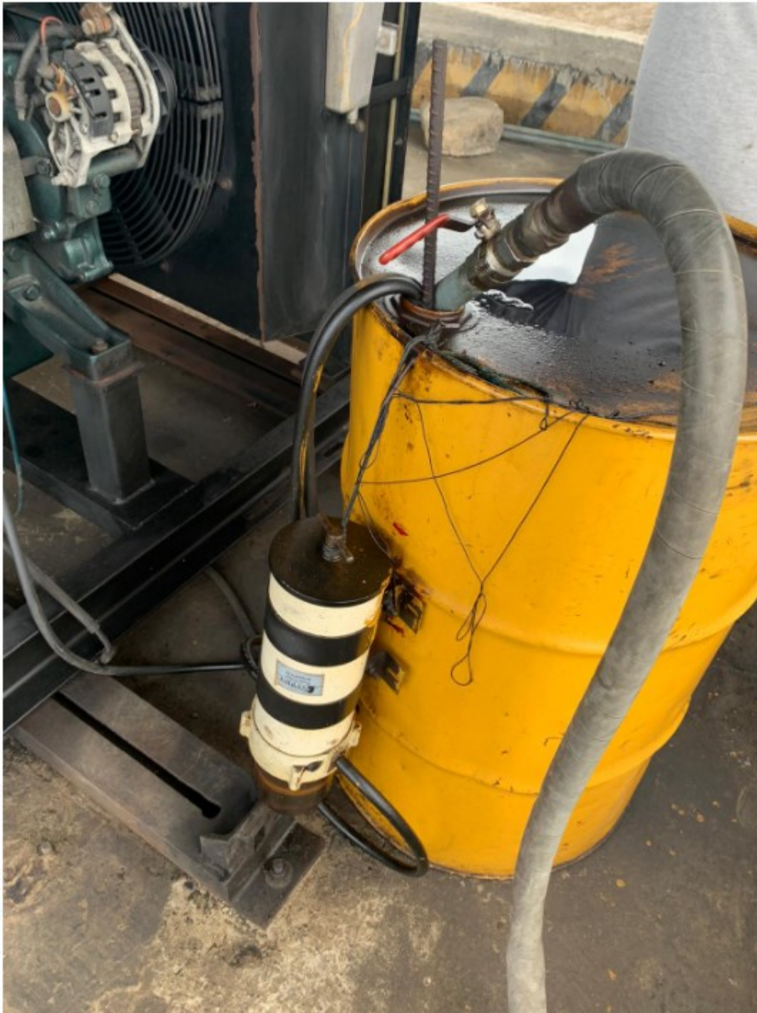
Anexo 9. Reservorio y filtros de combustible. Fuente: Autores
