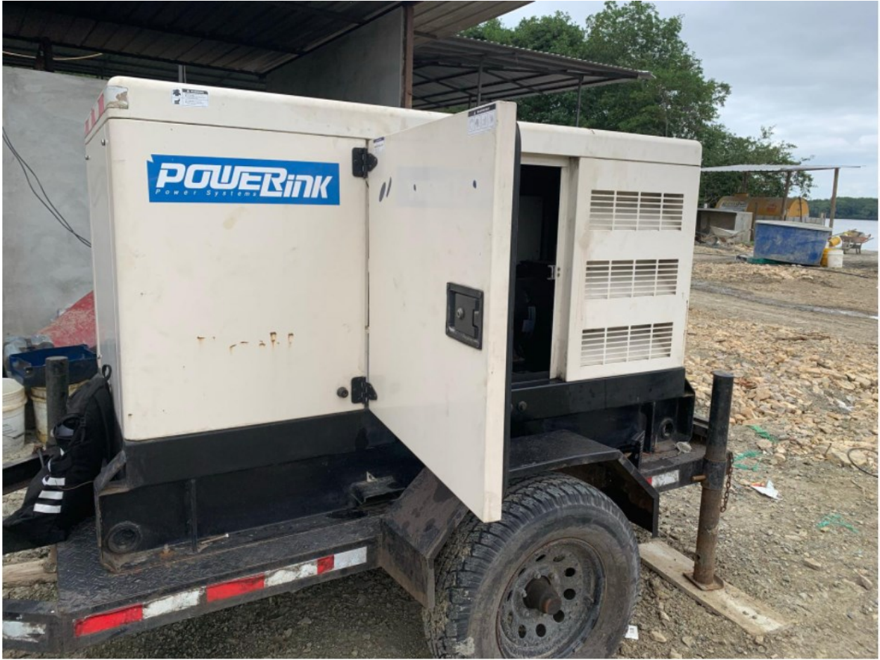
Anexo 6. Generador disponible. Fuente: Autores
