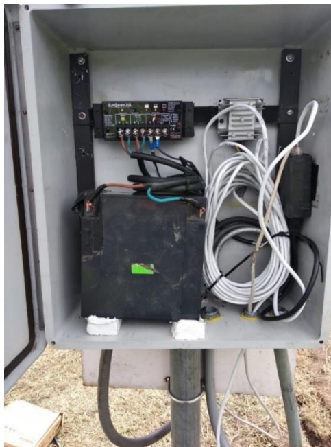
Figura 4.29 Gabinete de subsistema de comunicación
