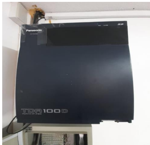
Figura 3.5 Central telefónica Panasonic Modelo KX TDA-100D utilizada para la empresa Delltex Industrial
