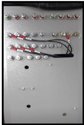
Figura 3. 9 Parte posterior cableada en la placa con borneras
