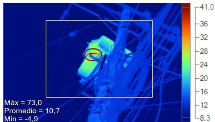
Figura 3.19. Revisión conector de puesta a tierra grado extremo
