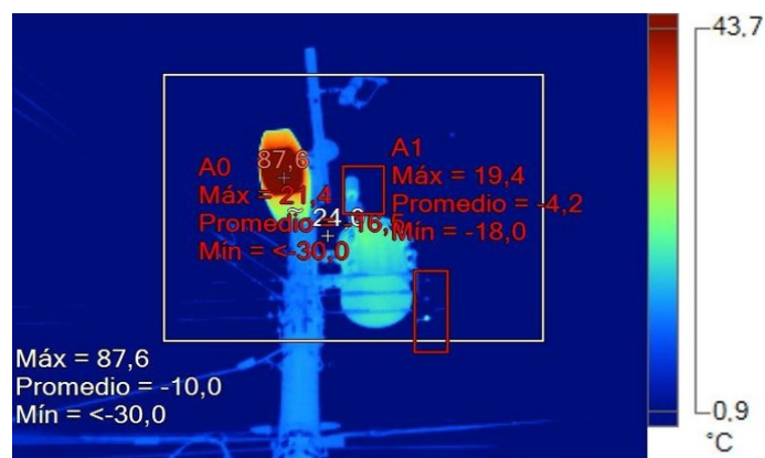
Figura 3.16. Revisión del conector y pararrayo severidad grave
