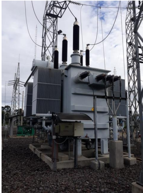
Figura 2. Autotransformador trifásico de potencia de la subestación Mulaló
