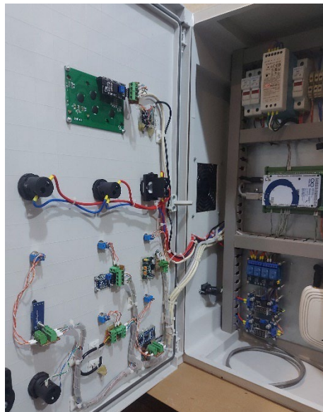
Figura 82: Cableado y conexiones del tablero.
