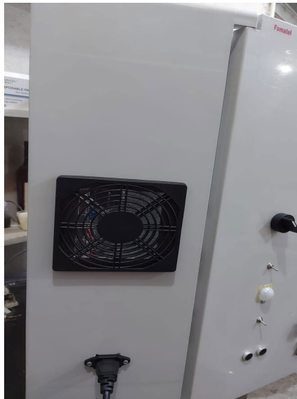
Figura 80: Rejilla de ventilación y plug de alimentación del tablero.
