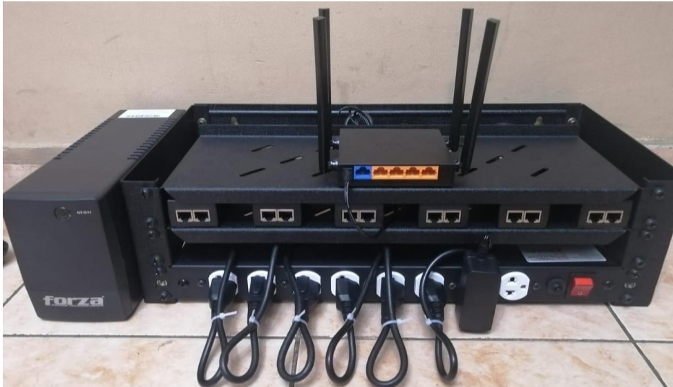
Figura 48. UPS para protección de equipos
