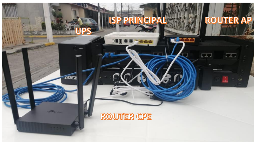
Figura 39. Conexión de equipos necesarios para establecer el radio enlace punto a punto.
