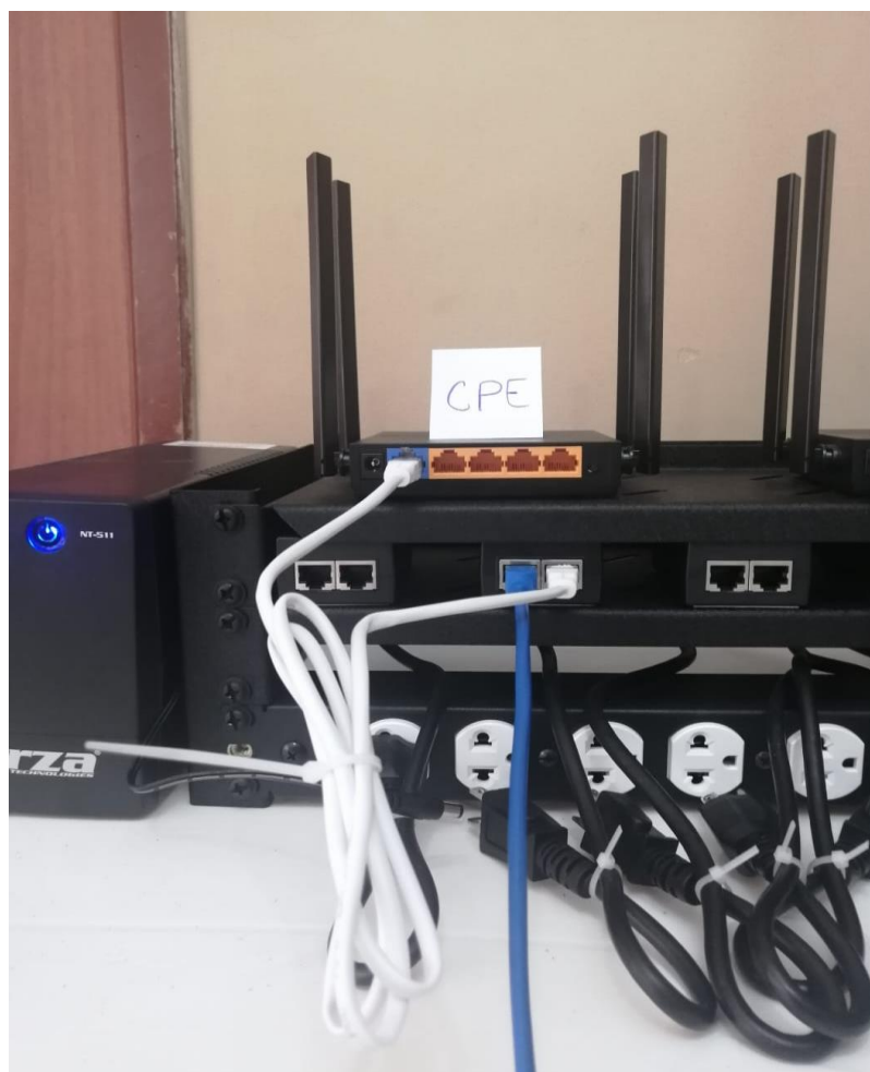
Figura 46. Conexión entre el router CPE y adaptador PoE de la antena.
