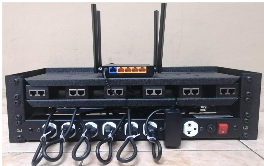
Figura 47. Infraestructura de rack armada
