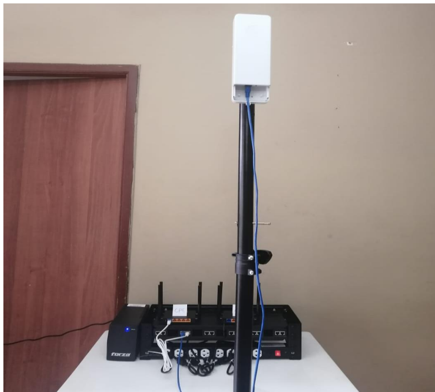
Figura 47. Conexión entre la antena suscriptora y el router CPE del cliente o usuario final.
