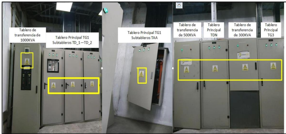
Figura 41: Tableros principales de alimentación y advertencias visuales.
