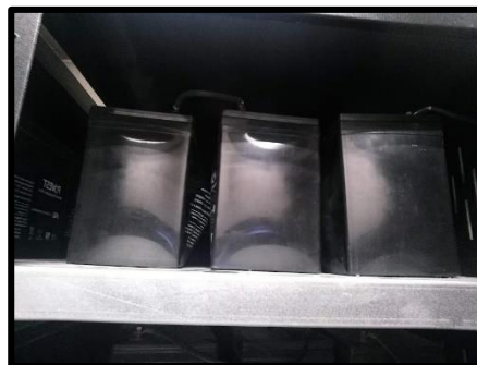
Figura 53: Baterías del SR 40KVA
