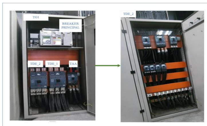
Figura 69: Tablero TG1 y Tablero TDE_2.
