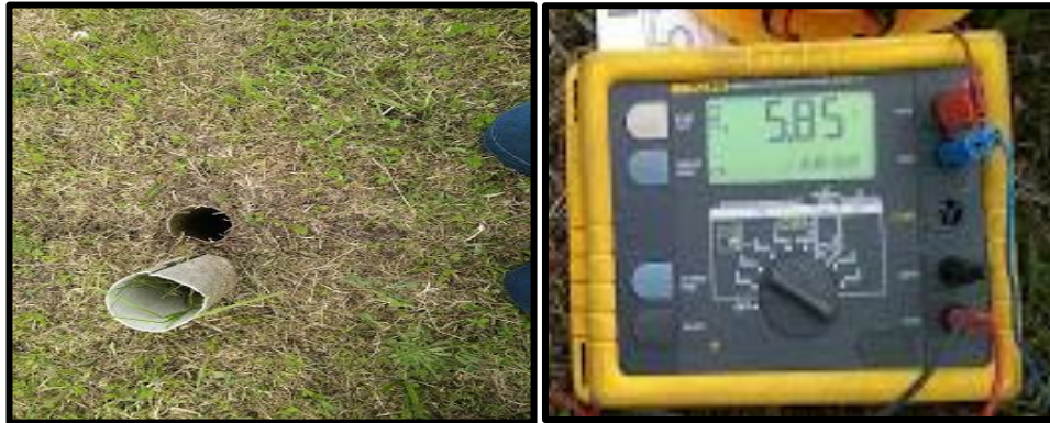
Figura 64: Al lado izquierdo el pozo de revisión en el tubo de PVC y a la derecha la medición de la resistencia.
