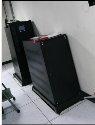
Figura 104: Armario de baterías
