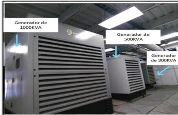
Figura 36: Generadores del HGONA.
