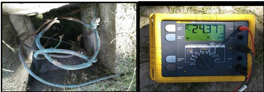
Figura 65: Revisión del pozo a tierra área de emergencia. Al lado izquierdo el pozo y a la derecha la medición de la resistencia.
