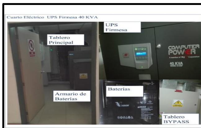
Figura 49: Cuarto eléctrico del SR 40kVA.
