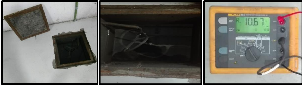
Figura 60: Revisión del pozo a tierra área administrativa.
