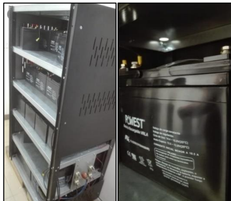
Figura 101: Baterías SR 10kVA baterías hinchadas.
