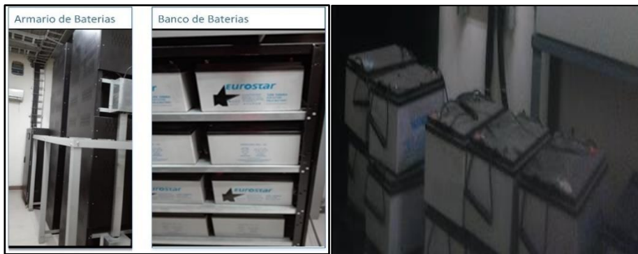
Figura 46: Baterías que se cambiaron en el SR de 120 KVA
