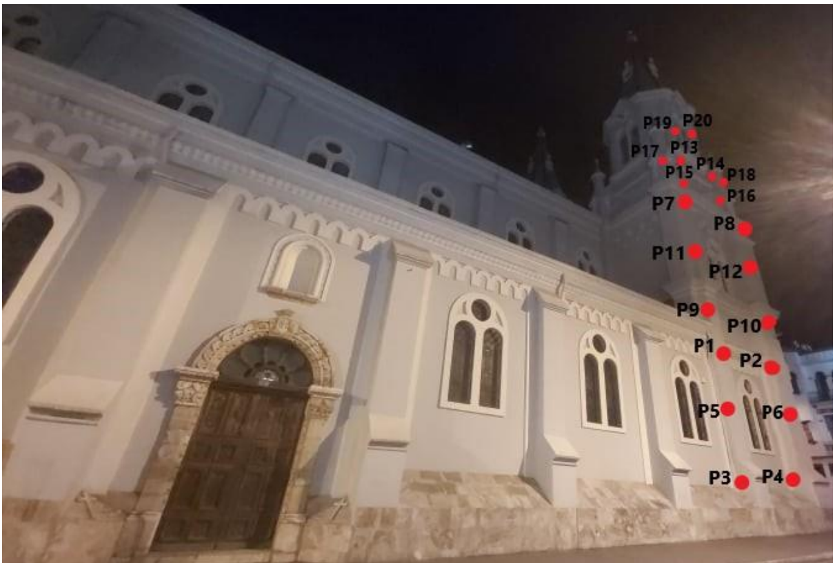
Fig. 51. Puntos de medición en la fachada lateral torre de la iglesia San Alfonso. [Autores]
