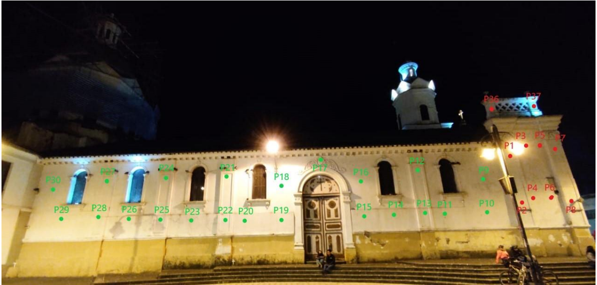
Fig. 30. Puntos de medición en la fachada lateral parque iglesia San Sebastián. [Autores]
