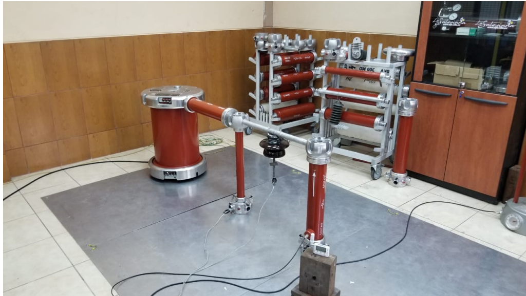
Figura 10: Distribución del Laboratorio de Alta Tensión.
