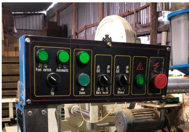
Figura 22. Tablero control actual máquina. (Fuente: Autor)
