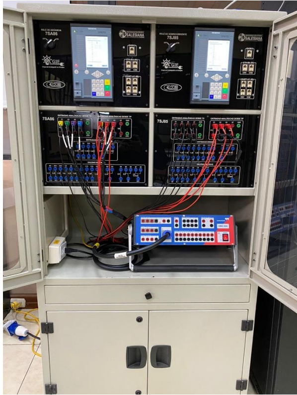
Figura 166. Banco de pruebas con IED's SIEMENS® y maleta CMC 356. Fuente: Autores.
