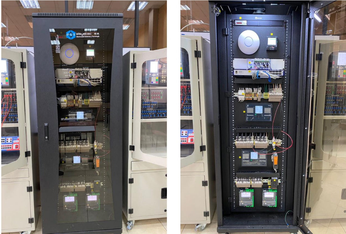
Figura 168. Rack de comunicación ELSYTEC. Fuente: Autores.
