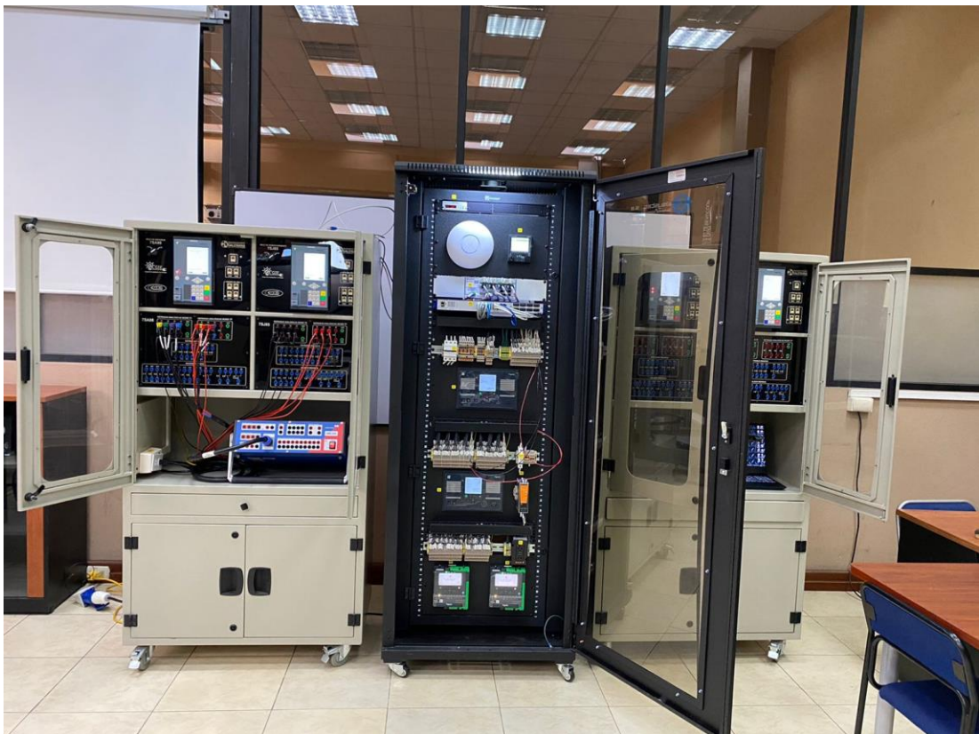
Figura 169. Laboratorio de Protecciones UPS. Fuente: Autores.
