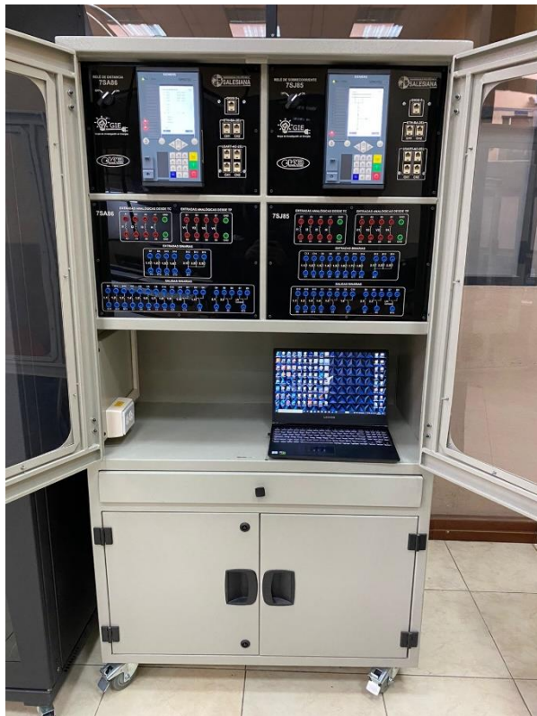
Figura 167. Banco de prueba #2 con IED's SIEMENS® y PC. Fuente: Autores.
