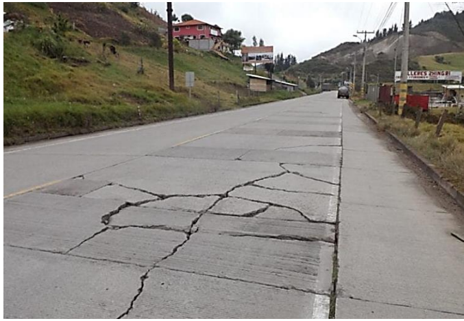
Figura 18. Estado actual de la vía hacia Girón, parroquia Tarqui.
