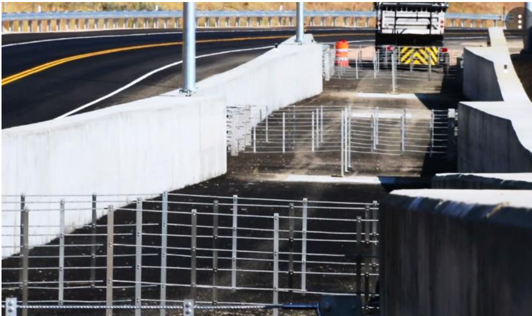
Figura 32. Vista de redes de frenado que componen el sistema TAS
