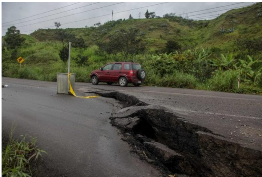
Figura 17. Estado actual vía cantón Girón.
