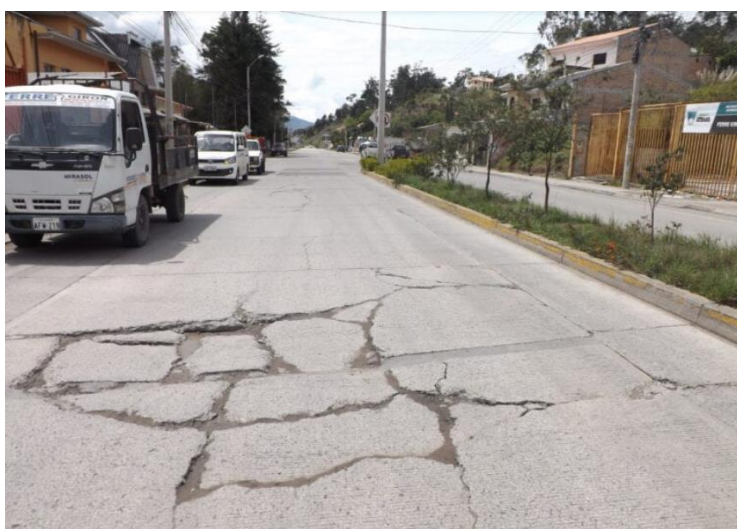
Figura 16. Estado actual vía cantón Girón.
