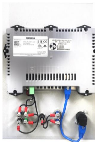
Figura 3.18. Cableado de Lámina Pantalla HMI KTP-700.
