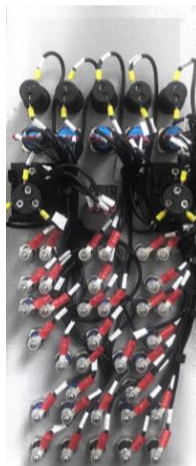
Figura 3.26. Cableado de elementos hasta los puertos de conexión.
