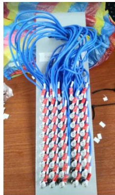
Figura 3.32. Cableado de todos los puntos de conexión.
