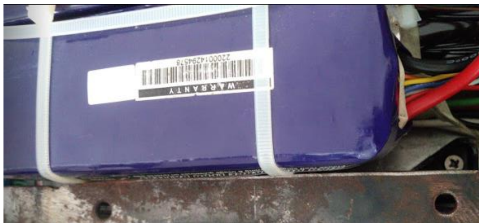
Figura 3.41. Batería rozando con la platina de la plataforma.
