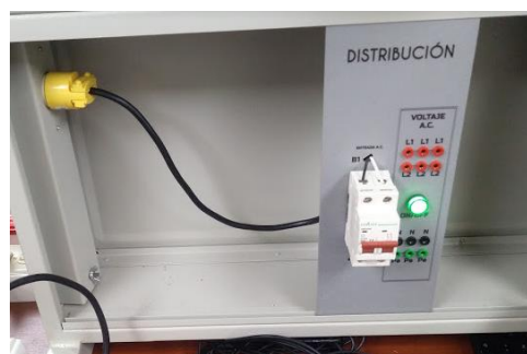
Figura 3.28. Prueba de funcionamiento.
