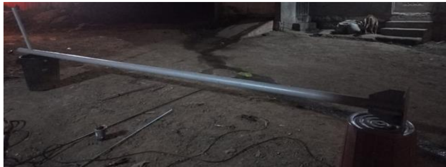
Figura 44. Poste a usar.
