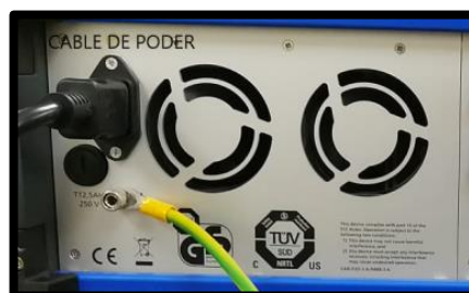
FIGURA 33: CONEXIÓN DE FUENTE DE PODER U PUESTA A TIERRA DEL CMC 356. FUENTE: LOS AUTORES.
