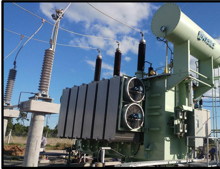
FIGURA 6: TRANSFORMADOR DE SUBESTACIÓN DE CENTRAL [11]
