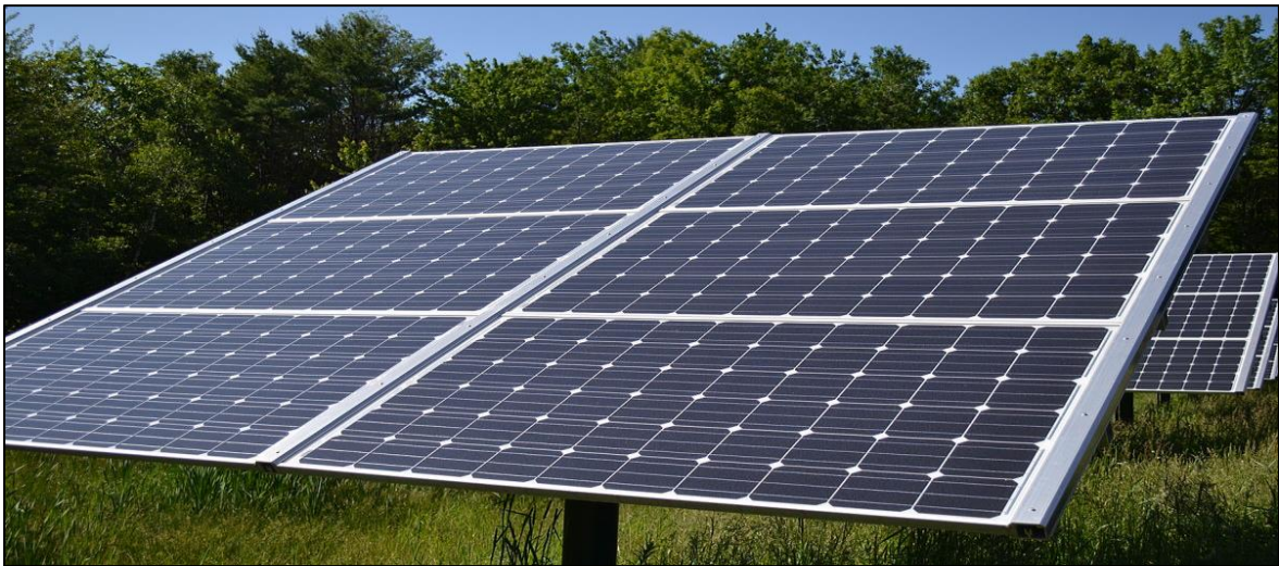
Figura 39. Ubicación de los 6 paneles solares con un ángulo de inclinación de 35°.
