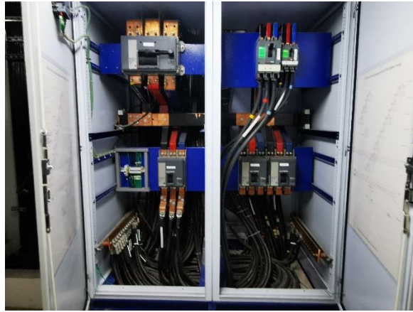
Anexo 21 Tablero de distribución principal
