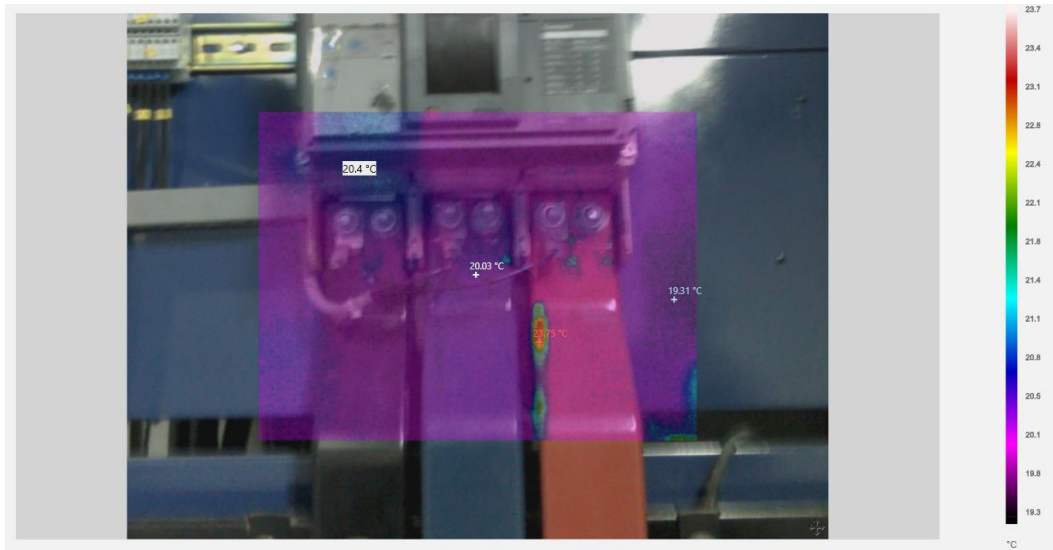
Figura 34 Imagen termográfica salida de bornes de conexión breaker TDP4
