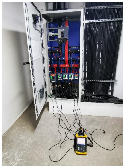
Anexo 20 Instalación analizador de red en TDP principal
