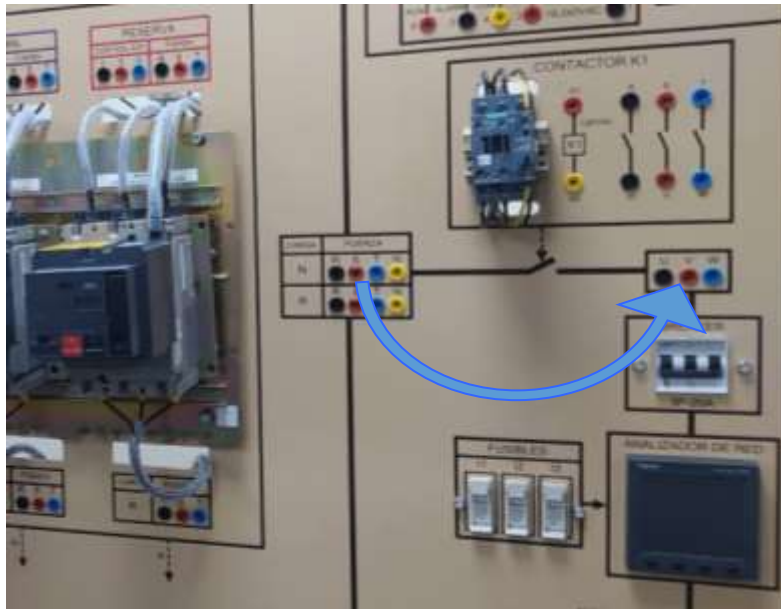
Figura 29: Conexión de Barra de carga "N" a Terminales U, V y W
