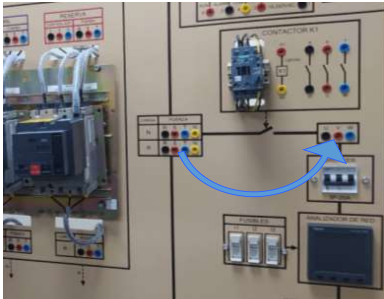
Figura 38: Conexión de Barra de carga “R” a Terminales U, V y W
