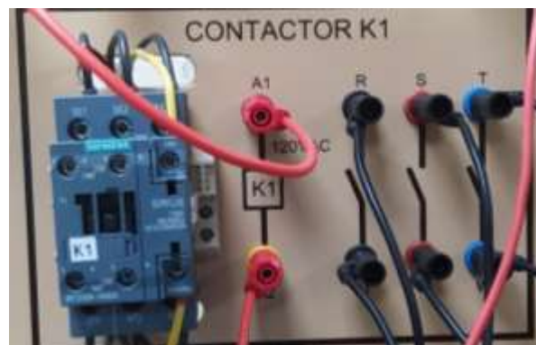
Figura 23: Contador trifásico - Módulo de transferencia
