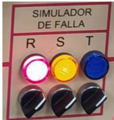
Figura 17: Luces Pilotos y Selectores - Módulo de transferencia
