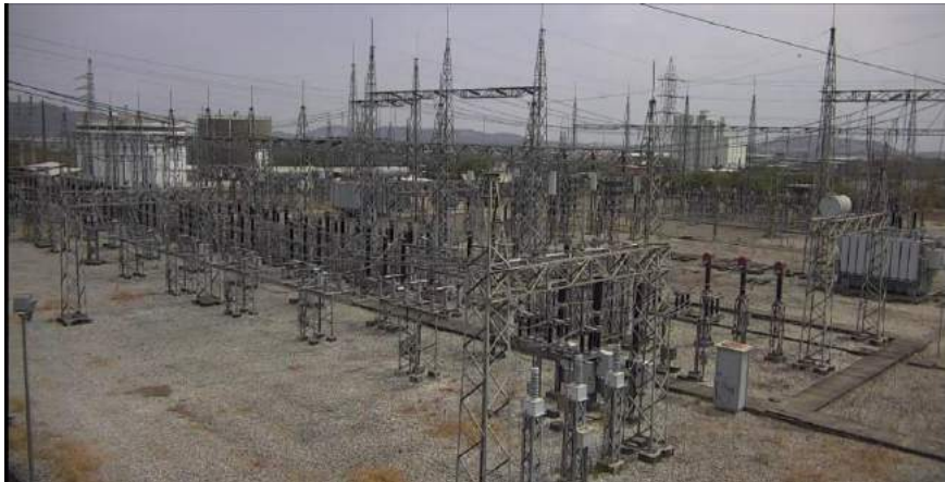
Figura 1.1: Patio 230 kV de la subestación eléctrica CELEC-EP TRANSELECTRIC Pascuales - Fuente: CELEC-EP.
