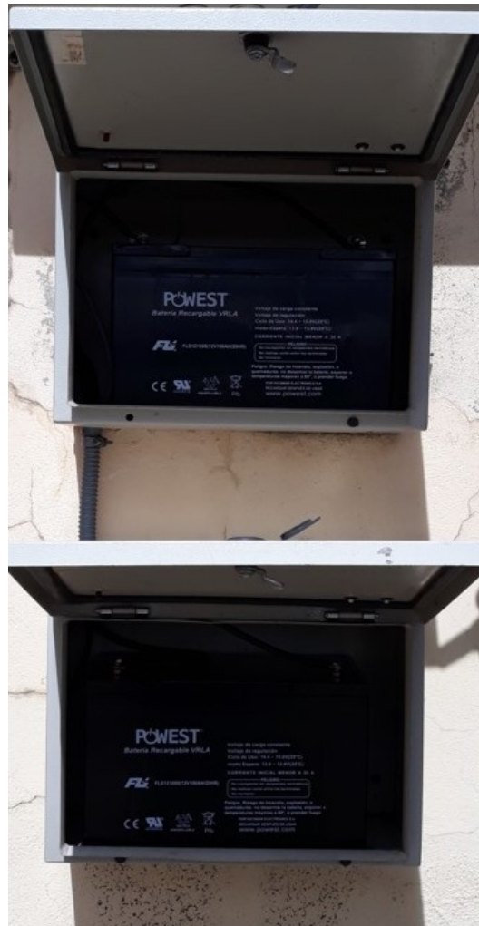
Figura 3.8: Banco de baterías conectadas en paralelo.
