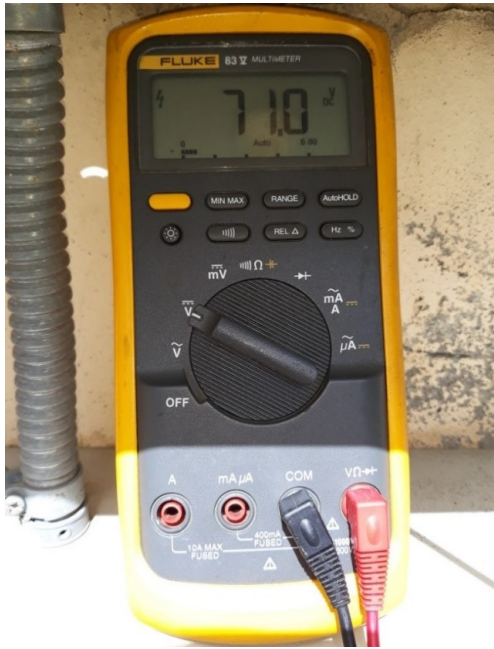
(a) Medición de voltaje.
