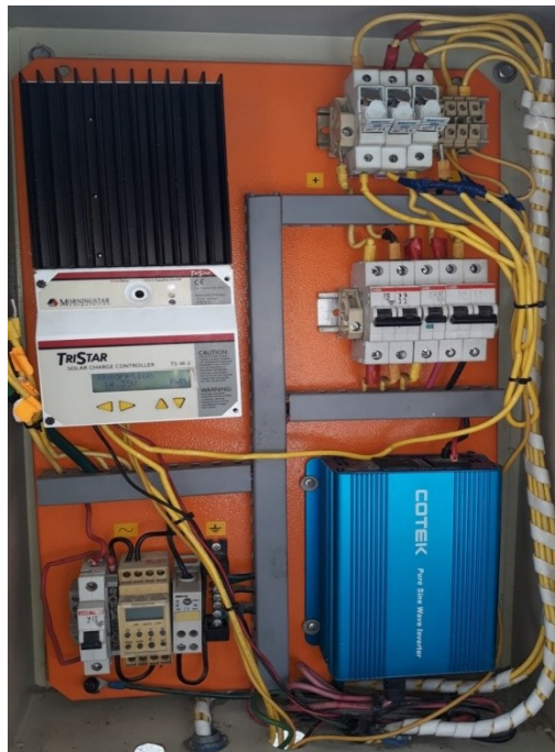
Figura 3.6: Tablero eléctrico para el funcionamiento del SFV.
