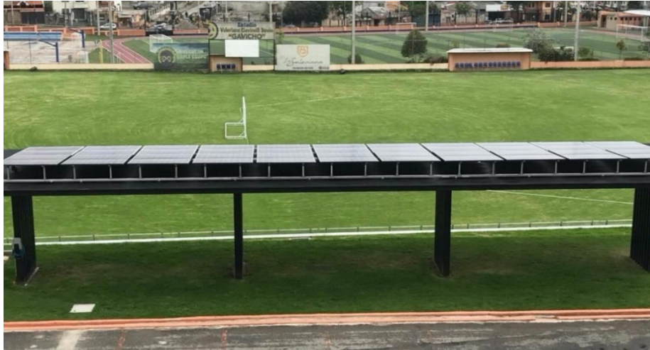
Figura 21. Vista frontal de la central FV de la UPS – Cuenca. Fuente: Vista frontal de la central FV de la UPS – Cuenca, 25 de agosto de 2020.
