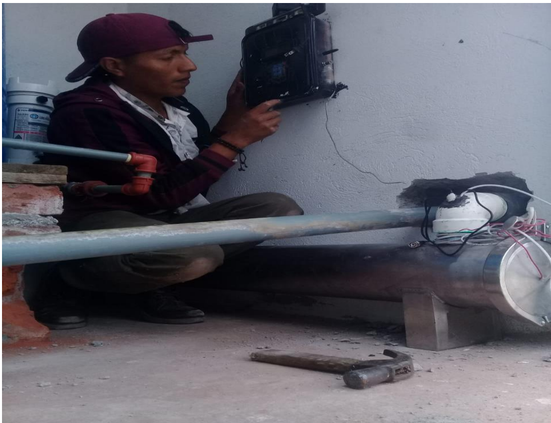
Fig.F 5 Implementación del panel del control [Fuente: Autor].
