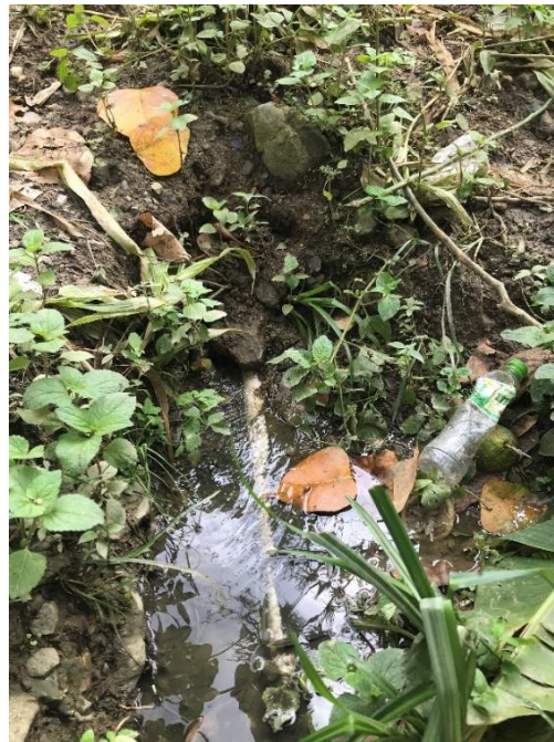
Ilustración 39 Estación 4, Biodigestor malogrado. Fuente: Autora.
