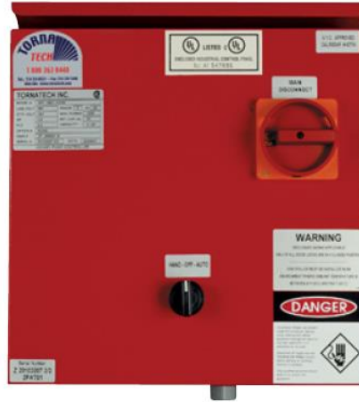
Figura 29 Tablero controlador bomba jockey
