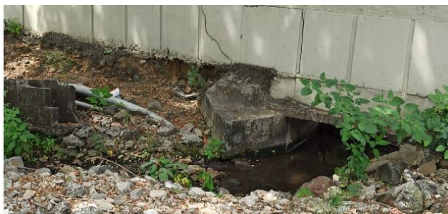
Figura 25.- Descargan de agua tratada directo al canal del río
