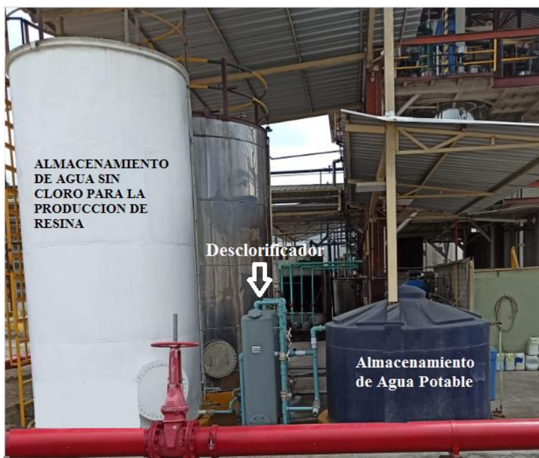
Figura 23.- Planta de desclorificación de agua potable para fabricar resina.
