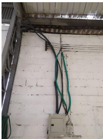
Figura 3. Acometida principal hacia el tablero de distribución de las instalaciones de la empresa Royal Master Group. Fuente: Autor
