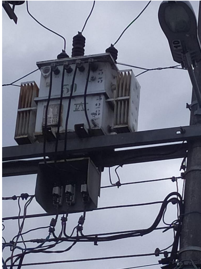
Transformador No. 33426, de 50 kVA, que alimenta a las instalaciones de la empresa Royal Master Group.
