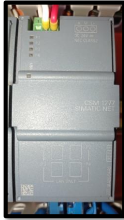
Figura 26 Switch de cuatro puertos a 24Vdc Siemens CSM 1277
