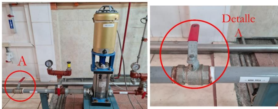
Figura 32. Sistema de bombeo planta A-1.
