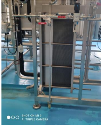
Figura 14. Intercambiador de placas.
