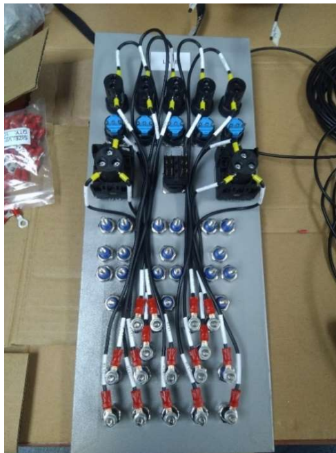
Figura 57. Vista del cableado para la lámina de mando y señalización.
