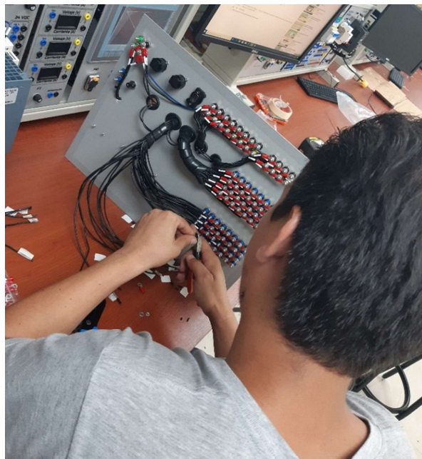
Figura 70. Conexión y cableado del PLC.
